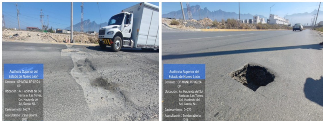
Imagen izquierda, falla número 1, Zanja abierta, cadenamiento 0+274 cuerpo Norte; Imagen derecha, falla número 2, Sondeo abierto, cadenamiento 0+270, cuerpo Sur. Fuente: Propia; obtenidas durante la inspección física.
