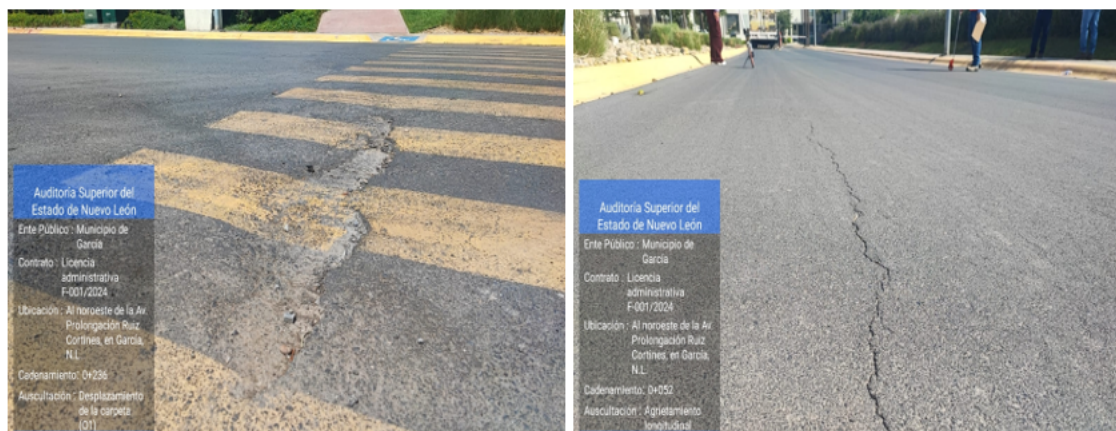
Imagen izquierda, falla número 1, Agrietamiento longitudinal, cadenamiento 0+052, Imagen derecha, falla número 8, Desplazamiento de carpeta, cadenamiento 0+236, ambas ubicadas calle Murano (Sur-Norte) entre av. Ruiz Cortines (0+000) y calle Venecia (0+330) (Tramo 1). Fuente: Propia, obtenidas durante la inspección física.
